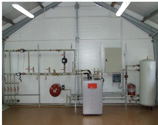
Rys. 2. Pompa ciepła oraz instalacja do odzysku ciepła w „Ekobudynku” (fot. R. Szulc)
